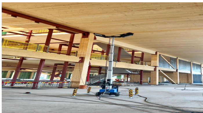
Figur 18. Visar belysningsmast i projekt B.
