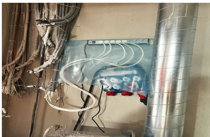
Figur 8. Översiktsbild över elinstallation i projekt A.
