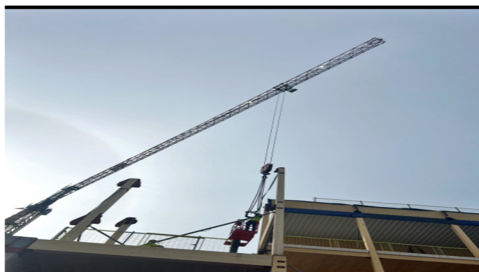
Figur 19. Visar kran med två kraftiga strålkastare.
